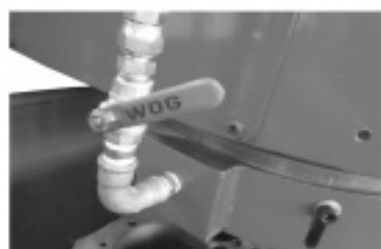
Válvula do sistema de refrigeração
